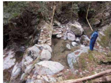
図3 大正時代に用居地区で使用されていた小水力発電用の堰堤
