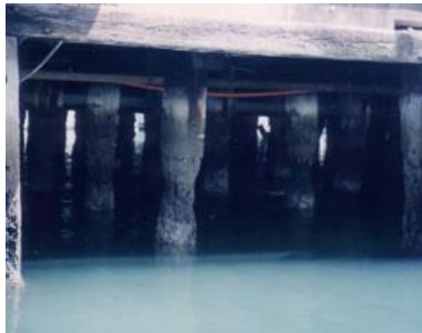
写真-2.3.8 海虫の食害を受けた 栈橋の木杭
