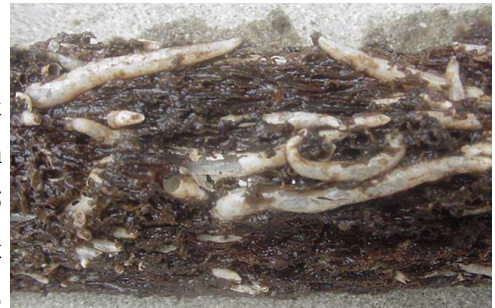
写真-2.3.2 フナクイムシの石灰質の棲管 (木材内部に形成された棲管が甲殻類の食害によって露出したもの)
