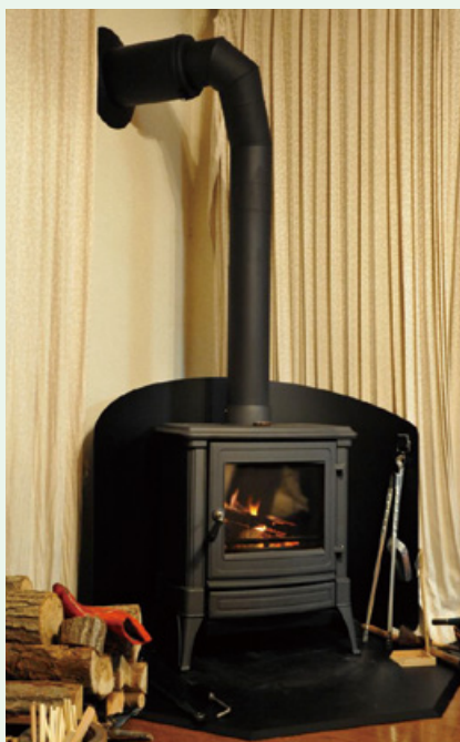
薪ストーブの設置例
