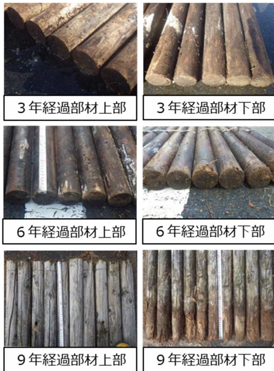
写真1 丸太伏工の経過年数と部材の様子
