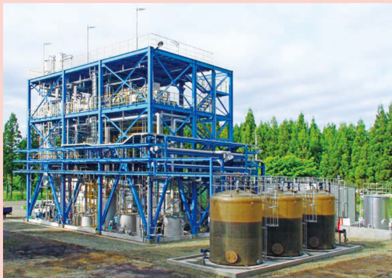
バイオエタノールのプラント (2008～2012年度)
