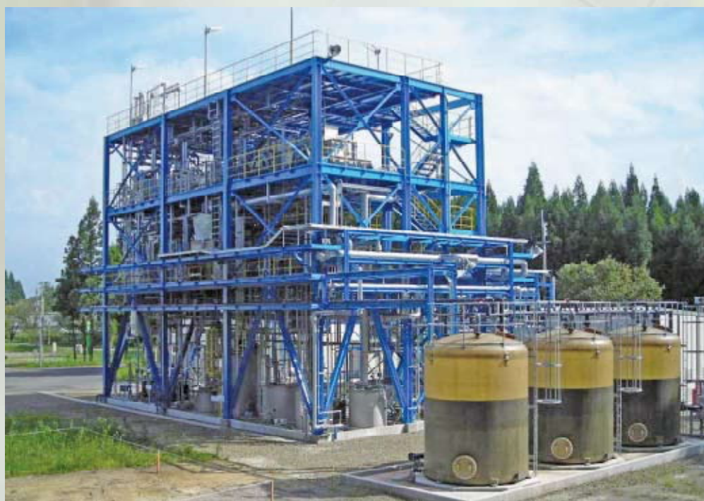
写真1 秋田県北秋田市に建設した木質バイオエタノール製造実証プラント
