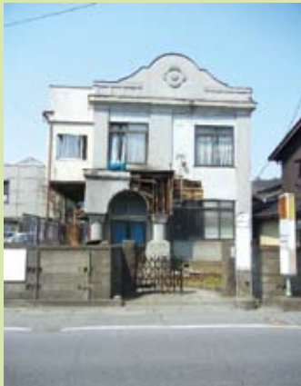
写真1 外壁モルタルが脱落した木造建物 （岩手県一関市）
