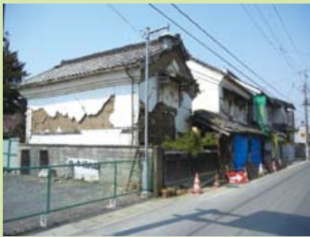
写真2 土蔵造木造の土壁剥落（宮城県登米市）
