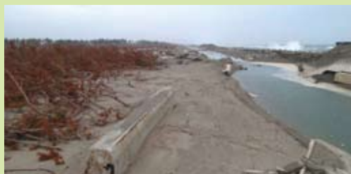
写真1 津波によって破壊された防潮堤(宮城県岩沼市) 防潮堤が破壊され海が見える(右上)。中央から右下への水面は、防潮堤を越流した津波によって洗掘された凹地。海岸林には防潮堤の構成材料が入り込んだ。
