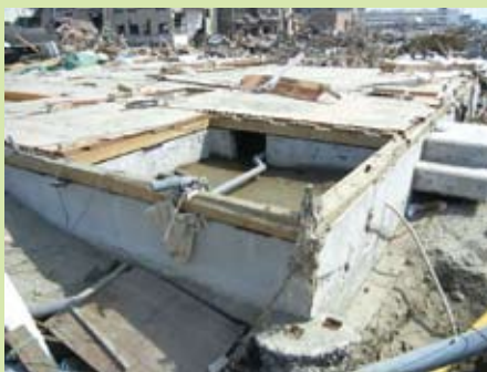
写真3 津波を受けて土台と基礎のみが残った木造建物 （宮城県石巻市）
