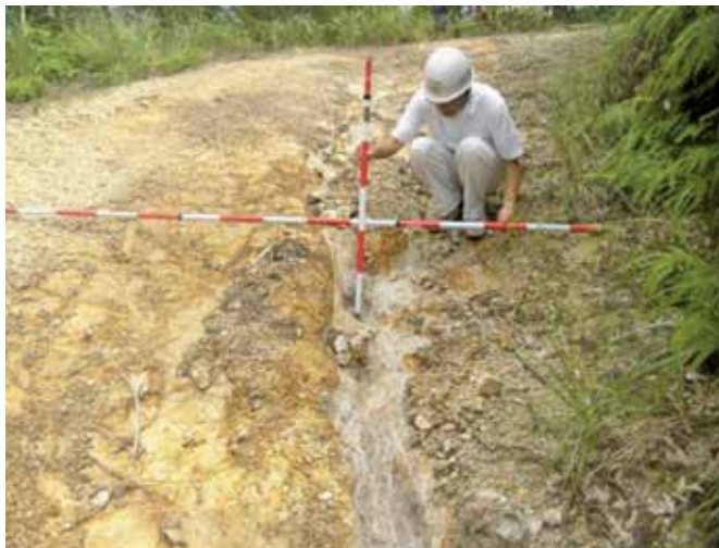
写真1 路面の洗掘や、敷砂利の流出
