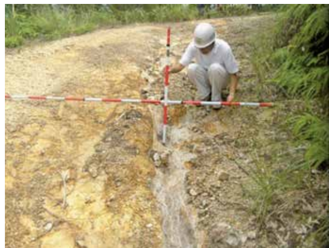
写真1 路面の洗掘や、敷砂利の流出
