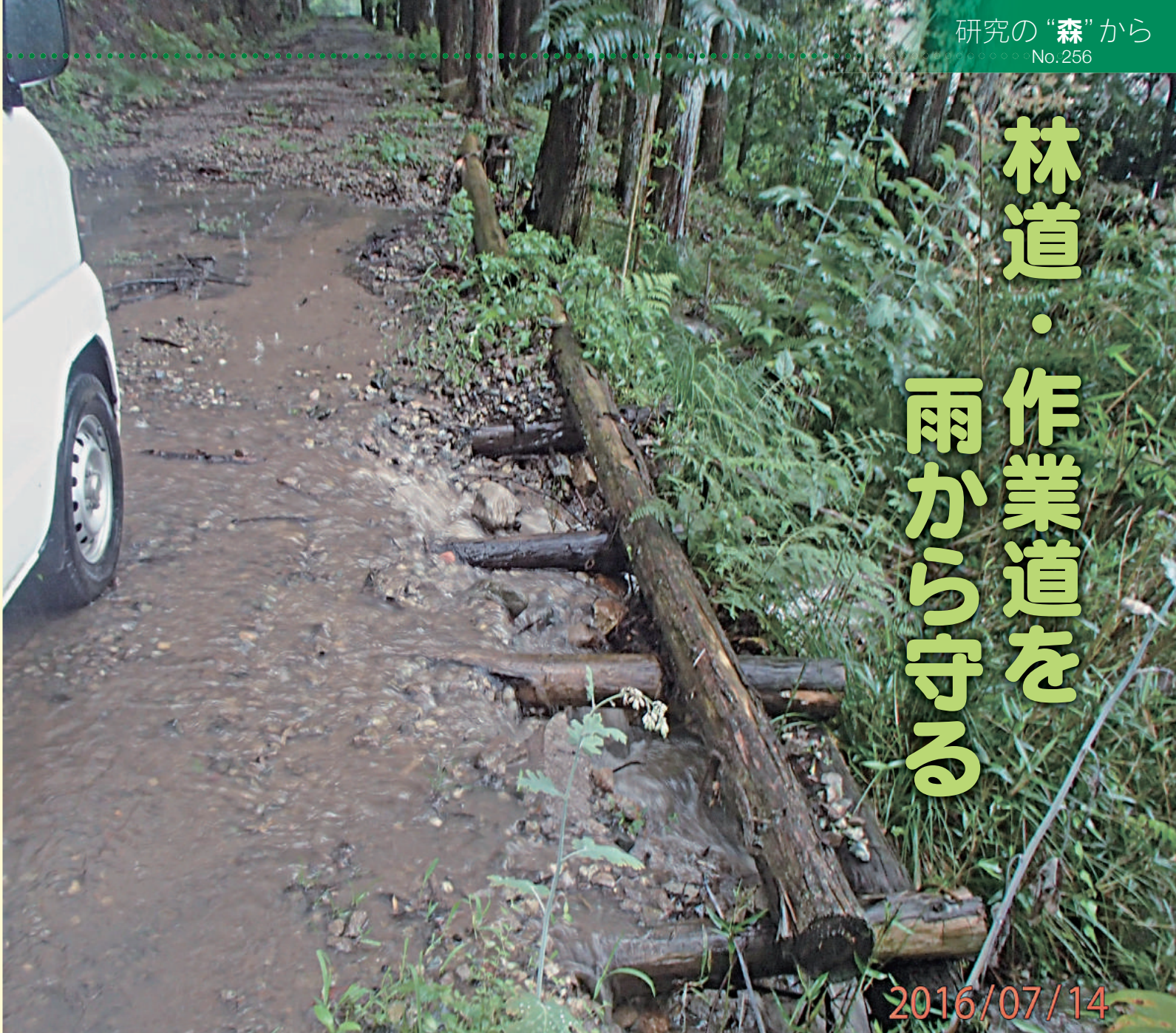
写真1 林道路面を流れる雨水
