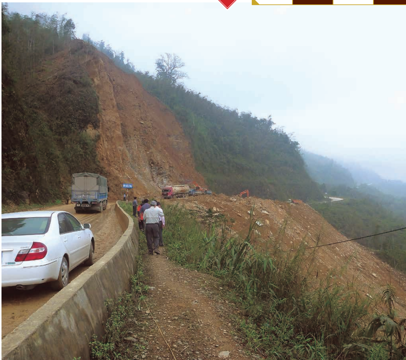
写真1 ベトナムの幹線道路沿いで発生した地すべり
