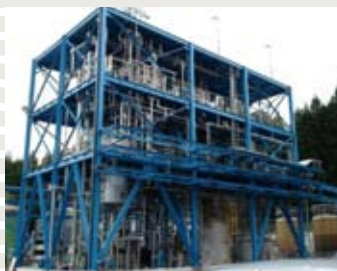
実証プラント全体
