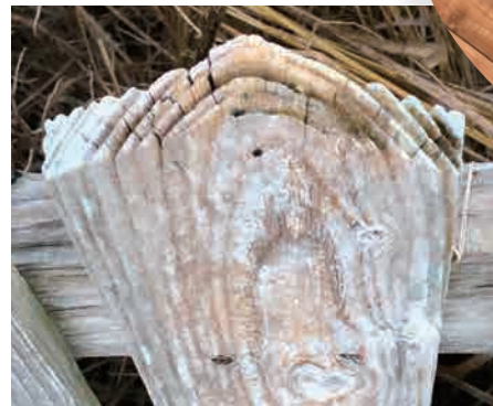
割れの発生と浸食による凹凸化の例
