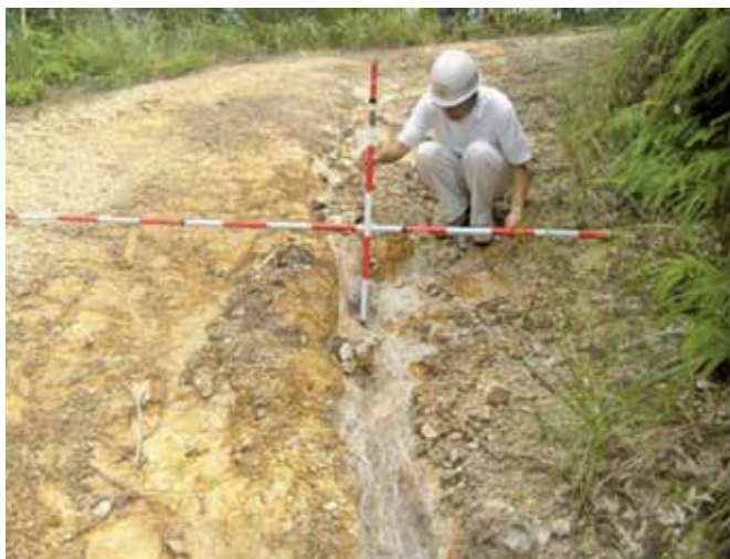
写真1 路面の洗掘や、敷砂利の流出
