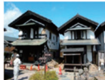
写真 3 土蔵の被害（大崎市）
