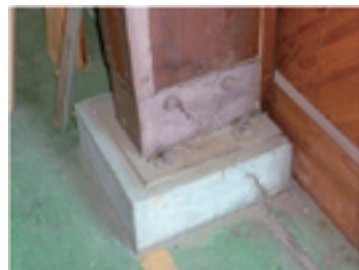
写真 1 4 柱脚部の基礎コンクリートの割れ
