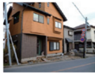
写真 9 地盤沈下により基礎底面が現れた住宅（牟田市）
