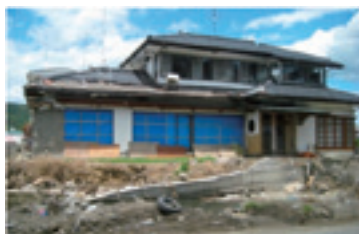
写真 1 1 被害を受けたものの残存する住宅（石巻市）
