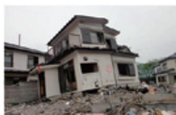
写真 1 2 津波により基礎ごと移動した住宅（釜石市）
