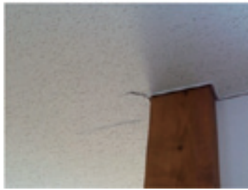
写真 17 天井の軽微な損傷
