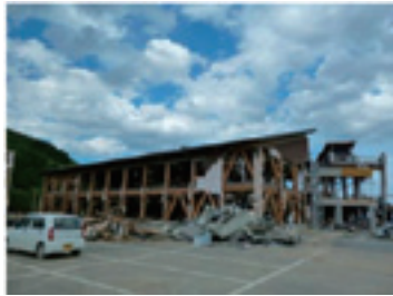
写真 2 2 津波を受けた北上総合支所の木造部分
