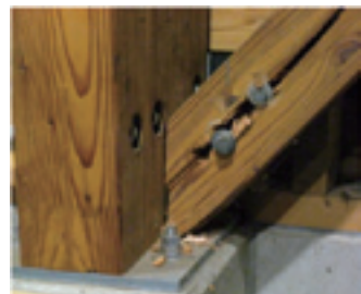
写真 1 5 筋かい端部の破壊
