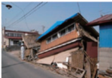
写真 1 住宅の倒壊（大崎市）
