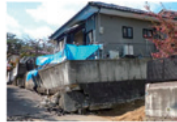
写真 6 擁壁の崩壊（仙台市）
