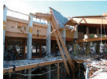
写真 2 3 折れて落下している大断面集成材の梁
