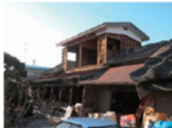
写真 2 住宅の大破（美里町）
