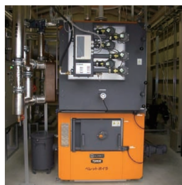
図 13 ペレットボイラー (福井県総合グリーンセンター)
