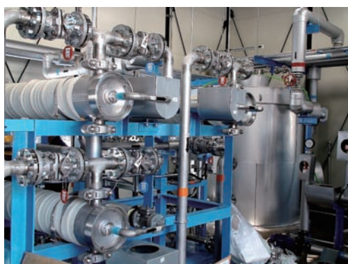
図 1 3 プラントに設置された 糖液濃縮装置
