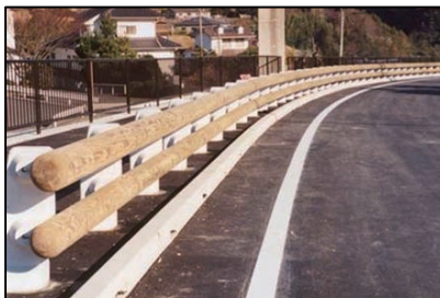
木製ガードレール
