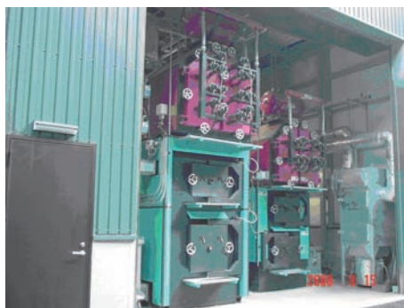
徳島上勝町温泉用チップボイラー
