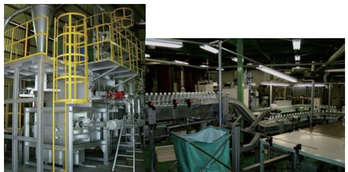
山梨県食品製造工場の用チップボイラーと製造ライン
