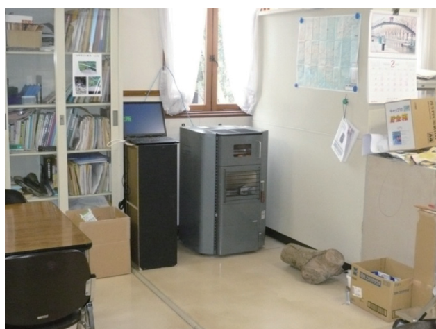
写真4-3 事務室内に設置したペレットストーブ
