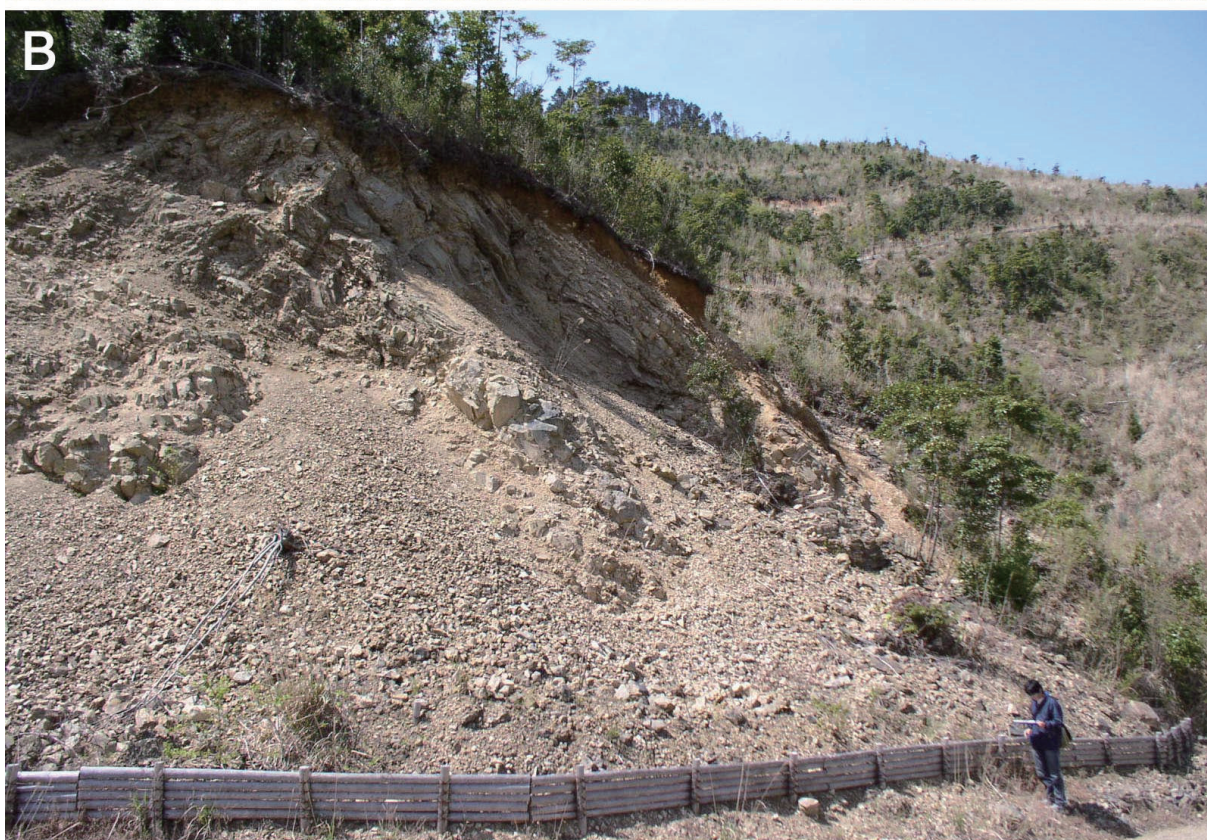
図 2-5 権現山皆伐跡地内の流れ盤斜面における切り取りのり面の崩壊. (A) 作業路沿いの小規模な崩壊. (B) 林道沿いの最大規模の崩壊（幅 30 m, 高さ 12 m 程度）
