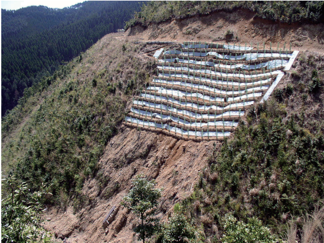
図 2-6 権現山皆伐跡地における最大規模の林道路肩崩壊（幅 30 m, 高さ 40 m 程度）
