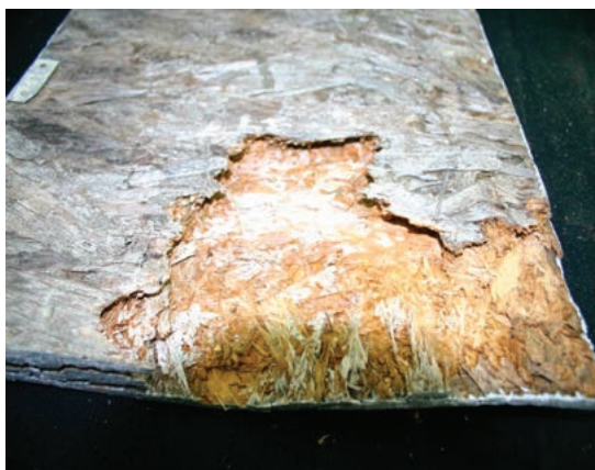
図4 水が浸入しやすいボード 激しく腐朽しているのが認められました。
