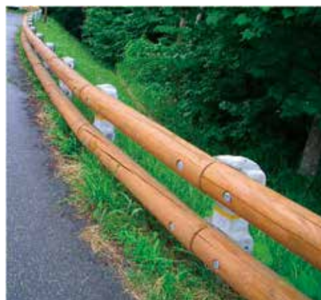
支柱に取り付けられた木製ガードレール
