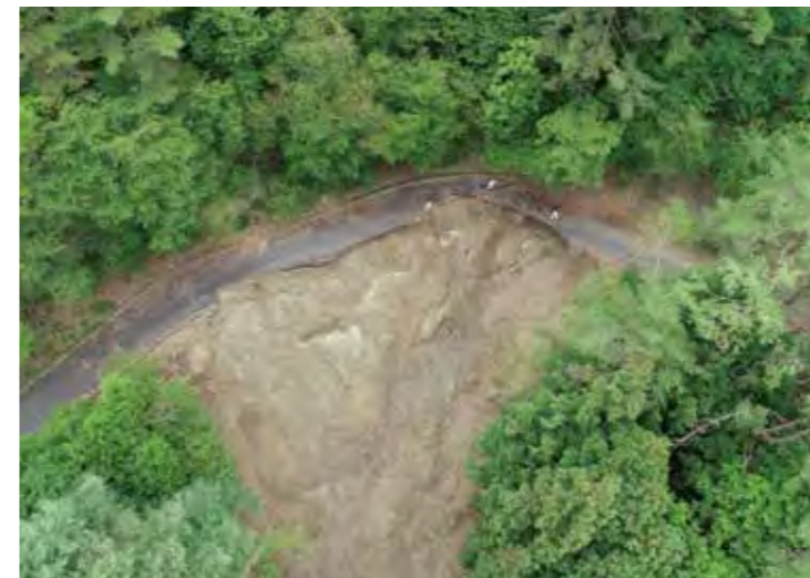
写真1 林道被害の様子(図2上部の被害箇所のドローン撮影画像)
