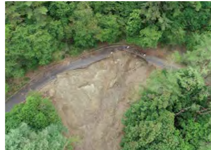
写真1 林道被害の様子(図2上部の被害箇所のドローン撮影画像)
