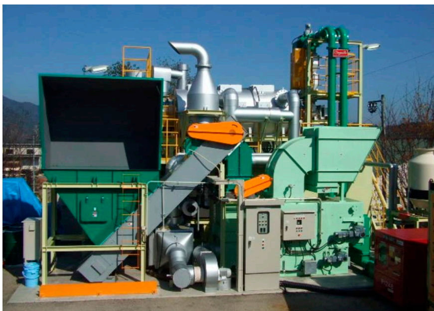
写真1 小型ガス化熱電併給装置
