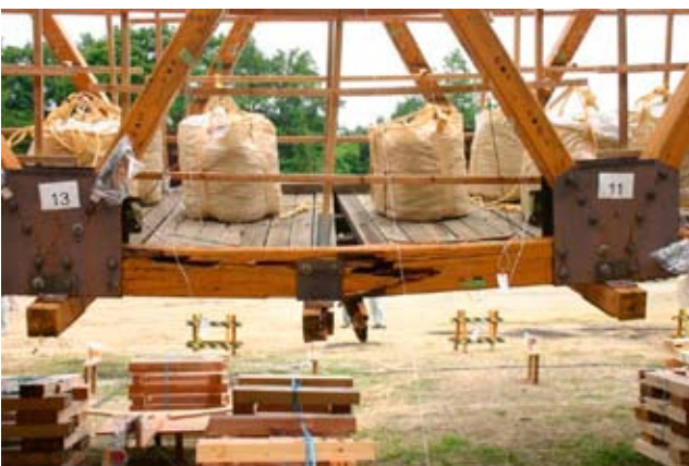
写真4 上流側下弦材の破断 (最初の破壊)
