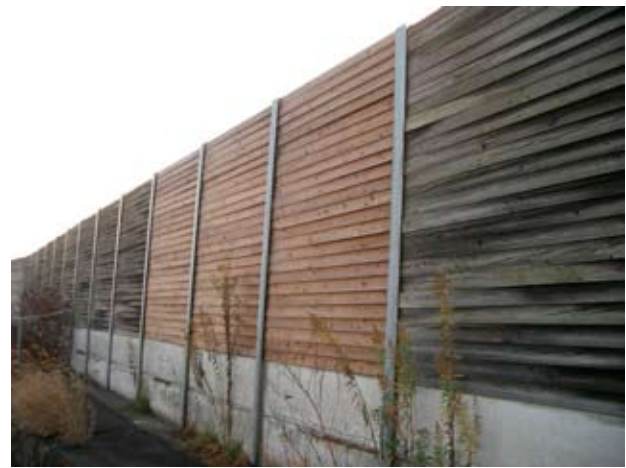
写真2 長野県に設置された木製遮音壁 (20年経過後の部分と交換された部分（中央分）)
