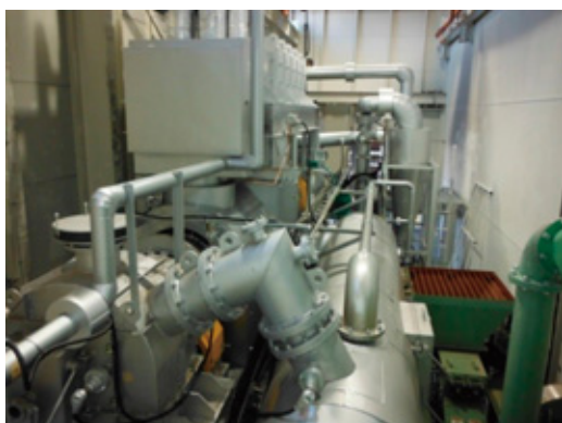
図2 実証プラント
