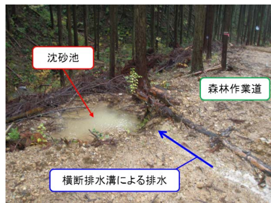
図4 横断排水溝による表面流の分散排水と流末に設置された沈砂池
