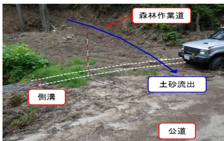
図1 森林作業道から流出した土砂により公道の側溝が閉塞
