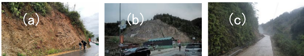
図 4-2-2-12 道路法面の状況. (a)切土後に法面保護がなされないため風化岩版が露出して表面侵食が生じる. (b)大規模な切土法面においても特段の対策はなされないように見える. (c)条件の良い一部切土法面では時間経過とともにシダ類が繁茂する.
