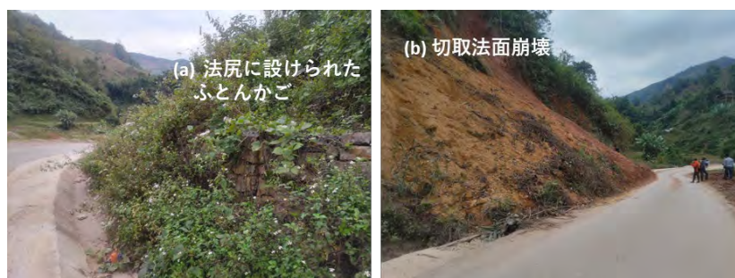
図 4-2-2-28 法面保護工と切取法面崩壊
