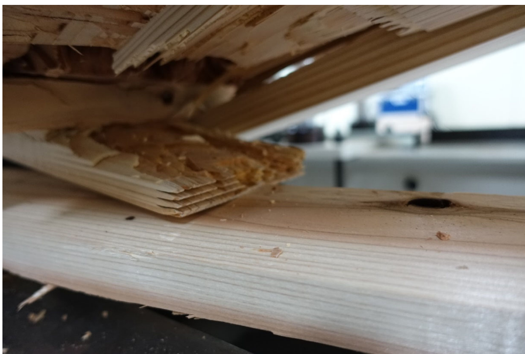
写真 4-3-4 DOL-94-1 梁下端フィンガージョイント部分の破断②
