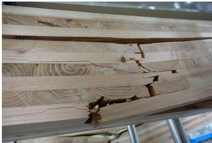
写真 7-3-2 DOL-86-1 梁下端フィンガージョイント部破断①
