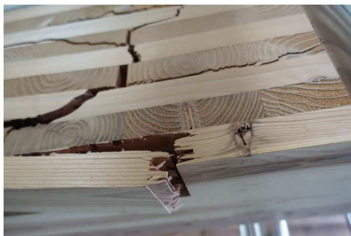
写真 7-2-8 DOL-70-2 破壊状況②
