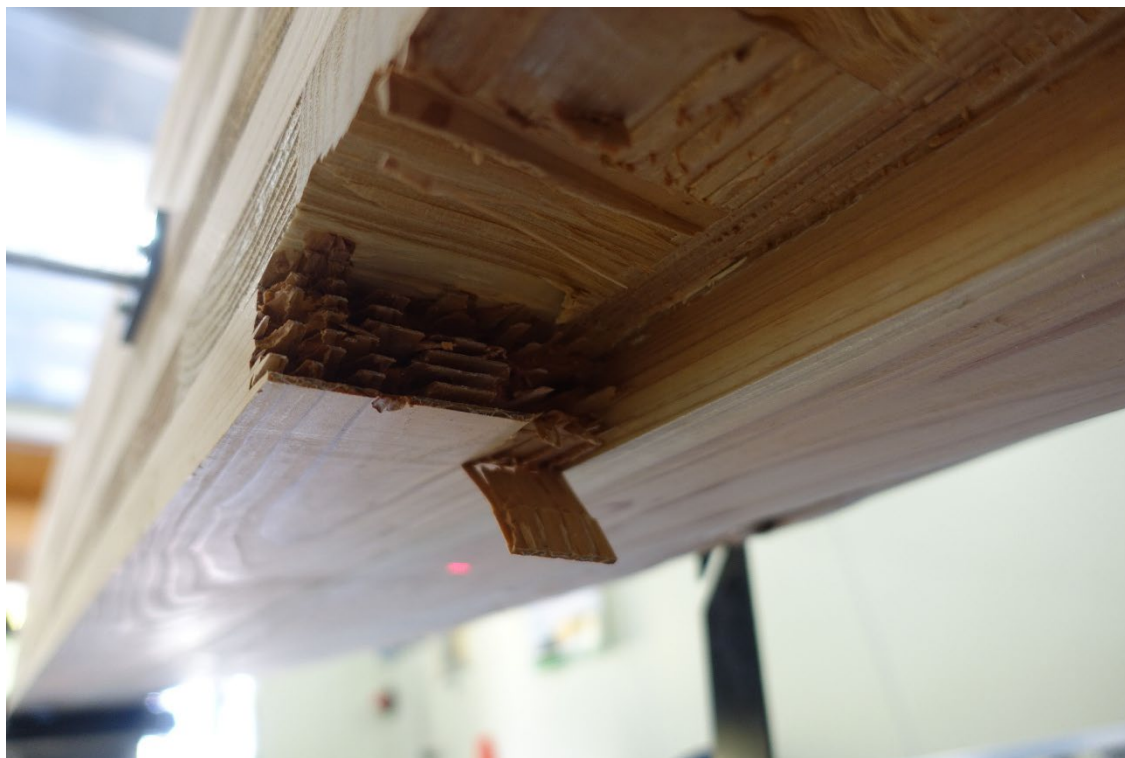
写真 4-4-4 D0L-74-2 引張側フィンガージョイント部分の破断
