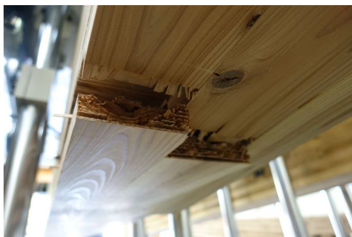
写真 7-2-9 DOL-70-2 引張側フィンガージョイント部破断
