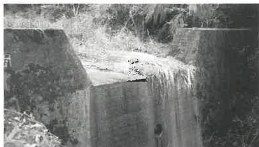
写真一 蒼社川事業区域 石ケ内容No.11谷止（昭和54年度竣工：H＝6 m）の満砂状況
