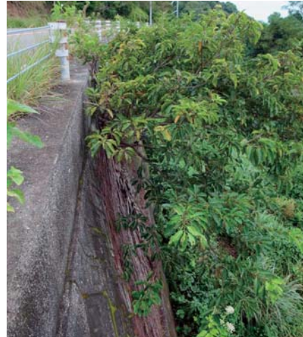
写真3 コンクリート擁壁にくっついたアコウ
