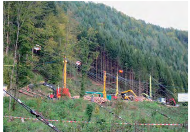
写真2 架線機械ゾーン
