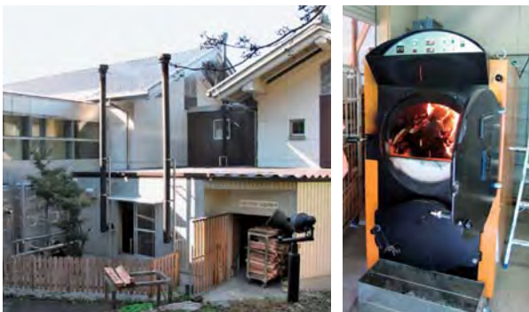
図2 左：薪ボイラー建屋（いの町の温浴施設） 右：薪ボイラー本体（須崎市の温浴施設）
