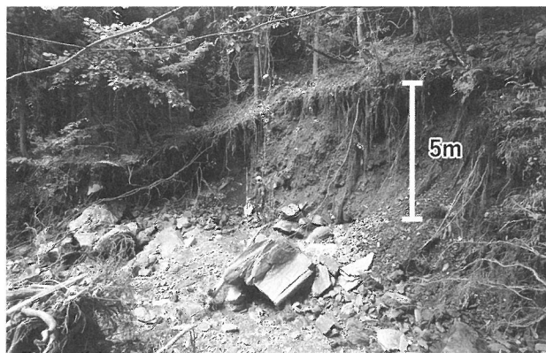
写真2 高さ約5mにわたって削られた溪岸(岩泉町栗喰沢)
