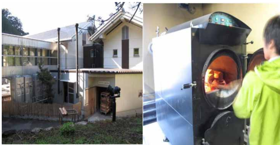
図1 温浴施設に導入された薪ボイラー
