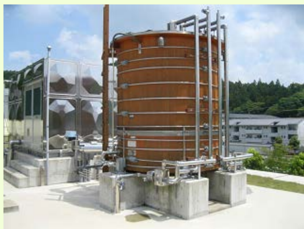
スギ心材製受水槽 浜松市天竜区
