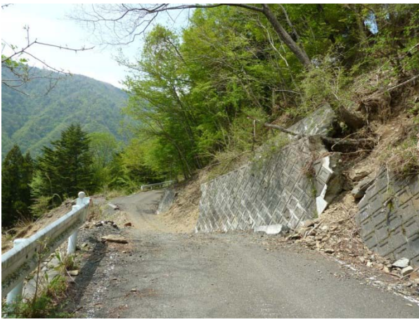
重力変形で壊れた林道
