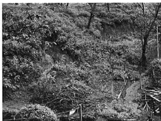
森の管理室前の崩れ
