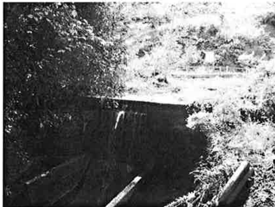
写真 8. 下流側堰堤。堰板により通水部が ふさがれている。
