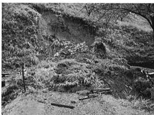
昭和林道と柳沢林道分岐点（災害位置図の①地点） （昭和林道方向から）
