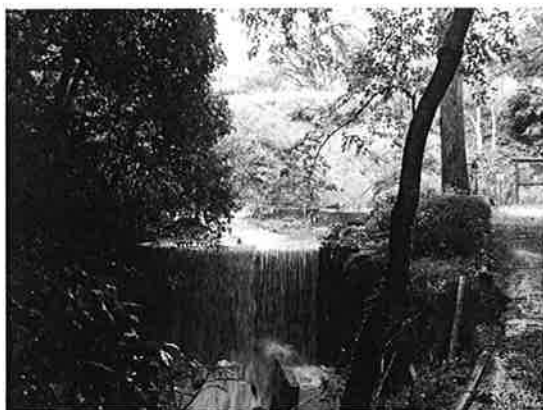
取水堰（脇が崩壊）
