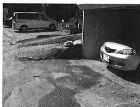
前日の雨で排水溝が土砂で詰まり、泥水が流出
